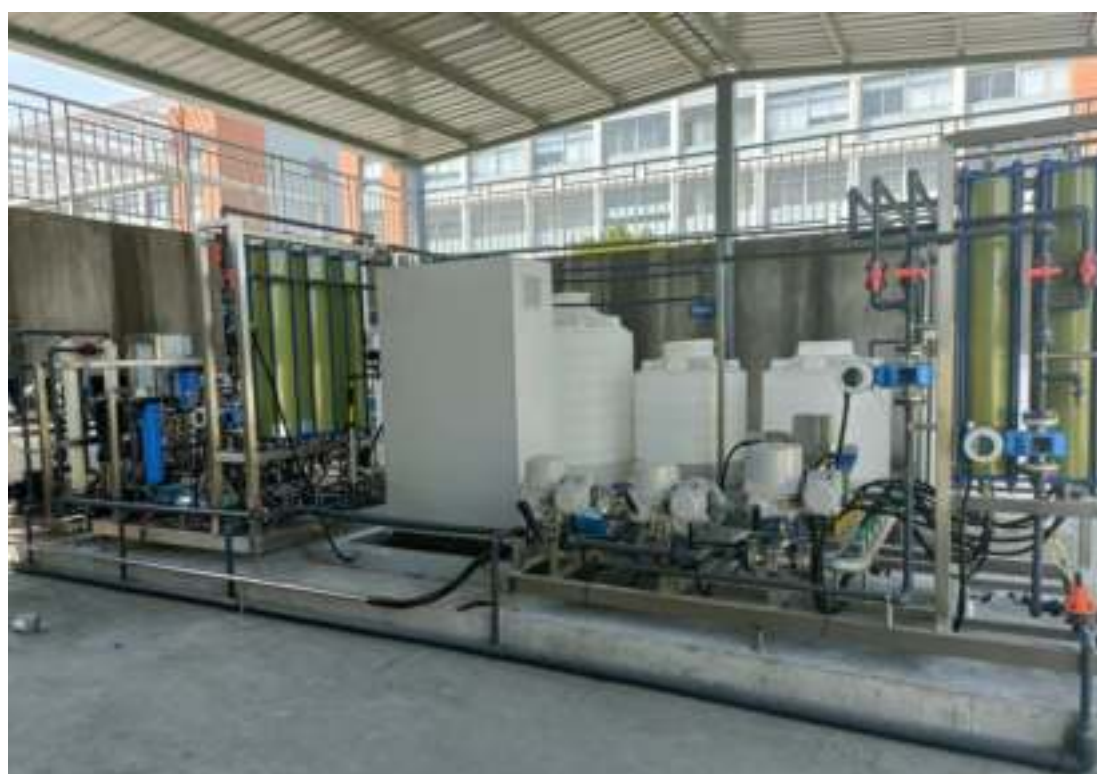
图 4.1-7 污水处理设施
